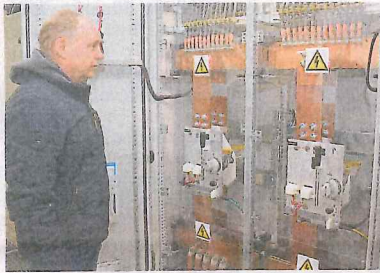
Martin Schölermann inspiziert den Schrank mit den Leitungen, die den Raum voller Akkus mit den Wechselrichtern verbinden.
